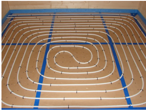
Fig. 1. Serpentin en polyéthylène constituant le plancher chauffant.
